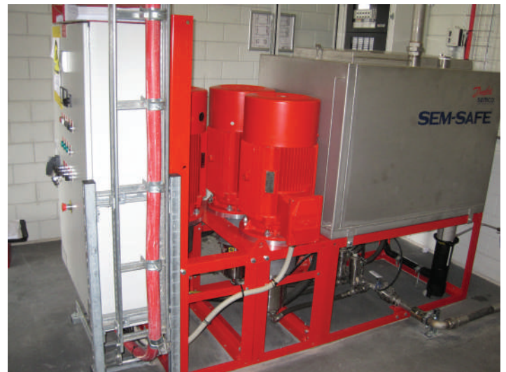
Kompaktes, im Equinix AM3 installiertes SEM-SAFE®-Pumpenaggregat.
