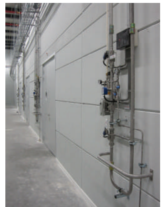
Montageort des vorgesteuerten Abschnittsventils der SEM-SAFE®-Anlage im Equinix AM3.
